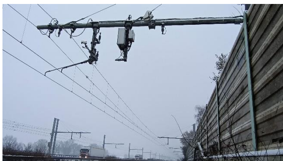
Abbildung 4 Erweitertes Messsystem an Messstandort Mast 46-18
